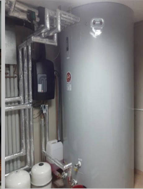
Wärmezentrale: 2000 L Wärme-Hamster
