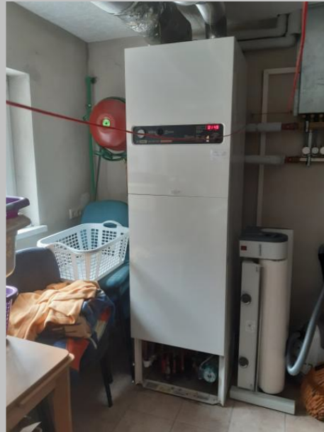
Alte Wärmepumpe von 1999
