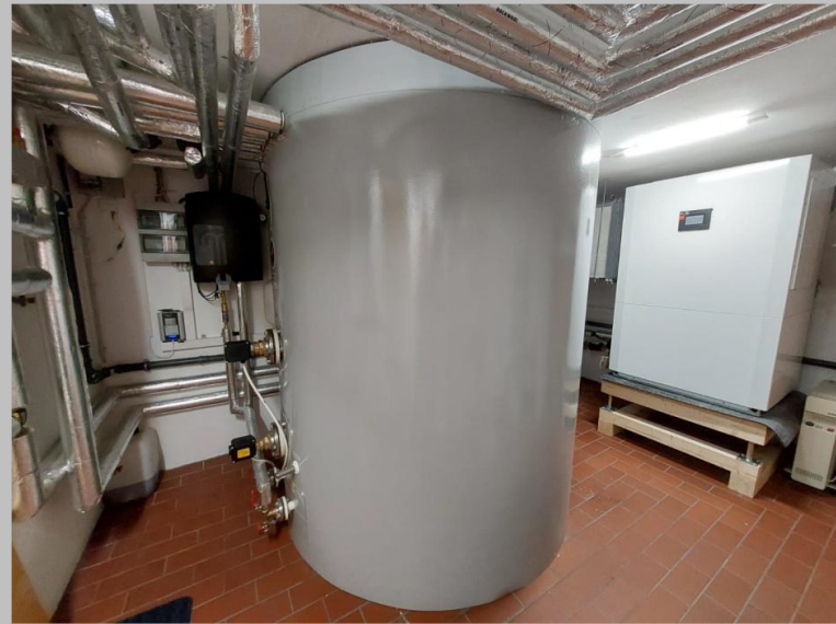
L/W-Wärmepumpe 9,4kW, innen aufgestellt
